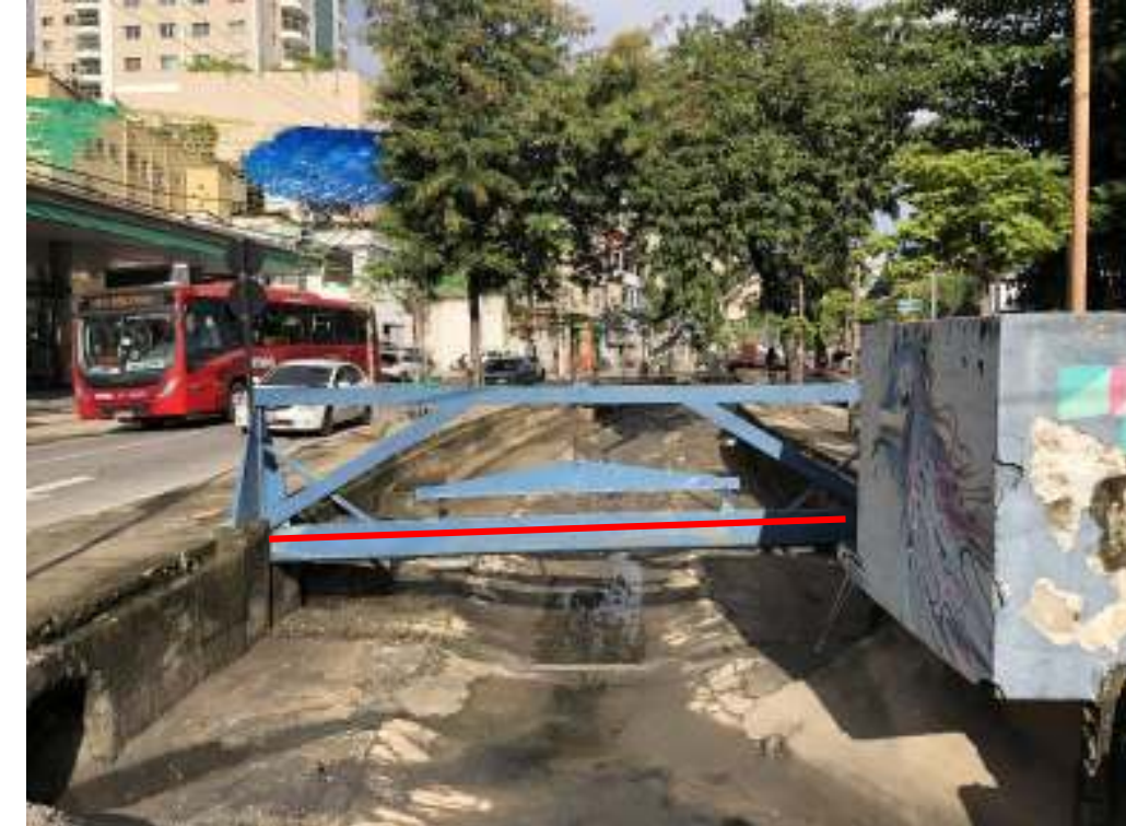
Figura 132: Dispositivo Instalado à Jusante da TTS.
