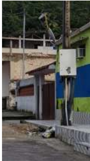
Figura 117: Macromedidor da 5ª Linha de Distribuição.
