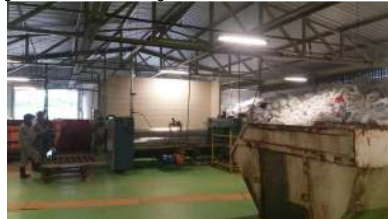
Figura 335: Vista interna e geral da Unidade de Tratamento dos RSS.
