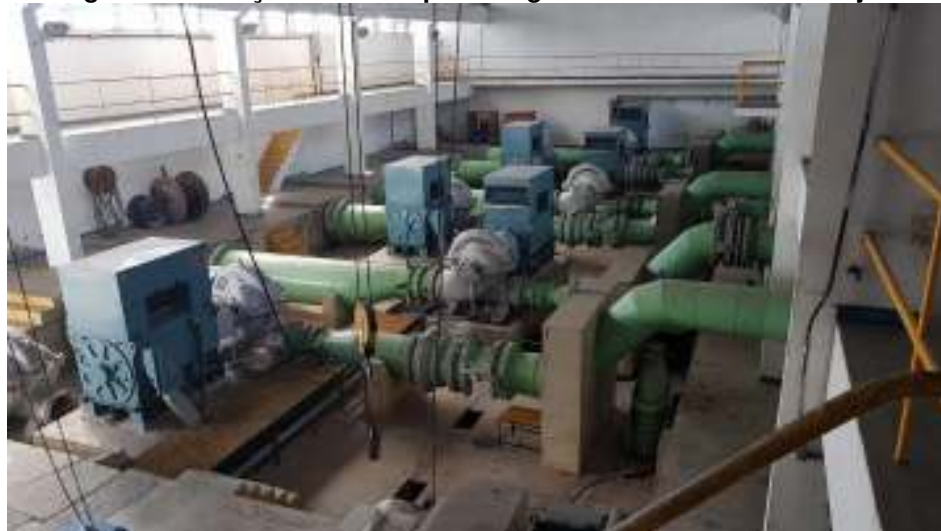
Figura 62: Estação de Recalque de Água Tratada da ETA Laranjal.
