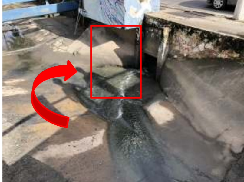
Figura 235: TTS Instalada em Canal de Drenagem no Bairro Icaraí.
