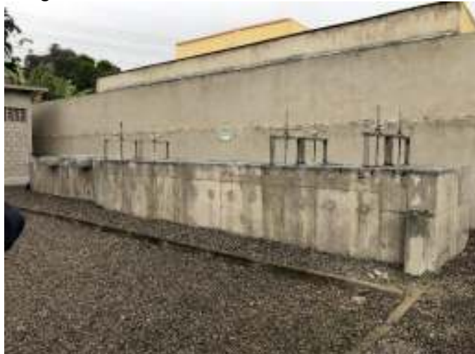
Figura 197: Tratamento Preliminar Convencional.
