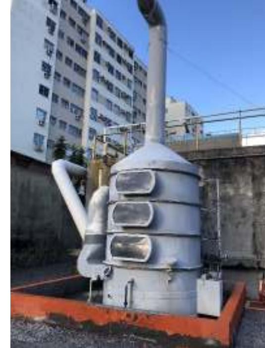
Figura 153: Lavador de Gás.
