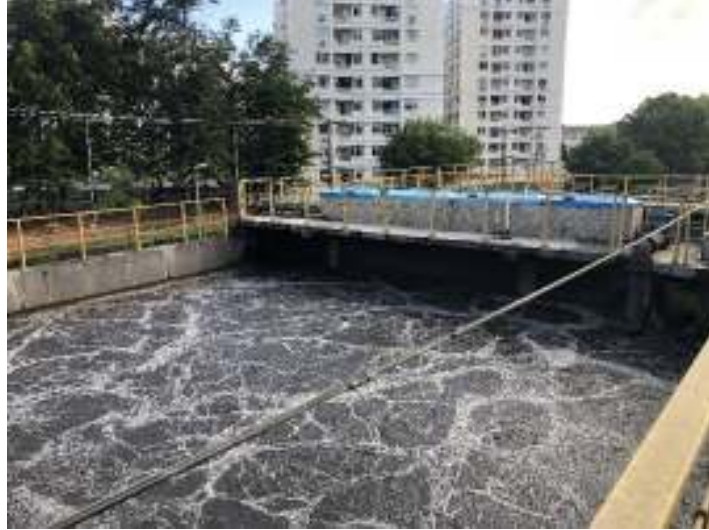
Figura 151: Tanques Aerados – Tratamento Secundário.
