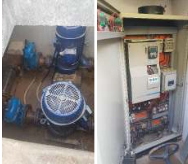
Figura 99: Booster e Acionamento do Booster do Reservatório Caramujo.
