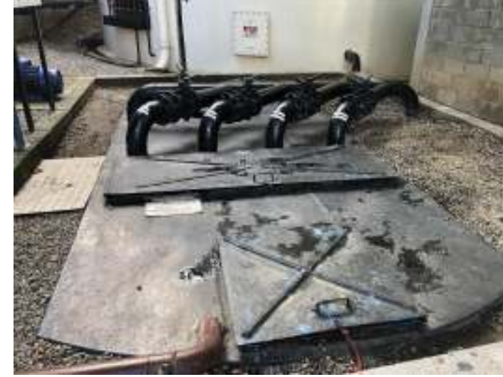
Figura 190: Recalque do Esgoto Após o Tratamento Preliminar.
