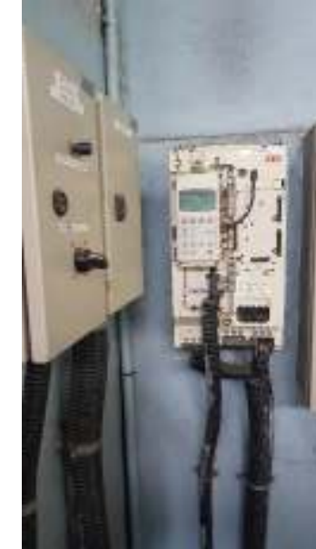
Figura 95: Acionamento do Booster Santa Bárbara.
