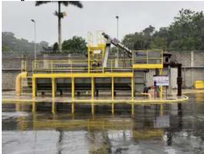
Figura 208: Tratamento Preliminar Automatizado.
