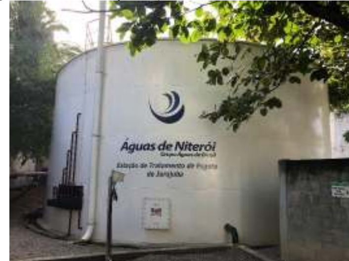
Figura 191: ETE Compacta (Tratamento Primário e Secundário).
