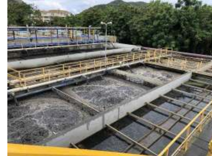
Figura 181: Tanques de Aeração.
