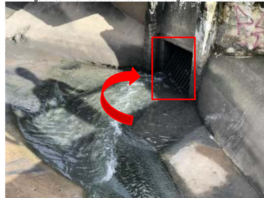
Figura 130: TTS Instalada em Canal de Drenagem no Bairro Icaraí.
