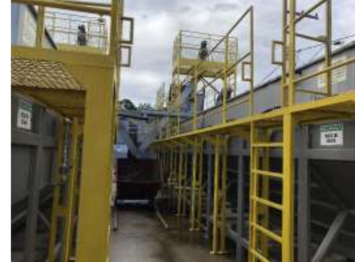
Figura 158: Tratamento Preliminar Automatizado.
