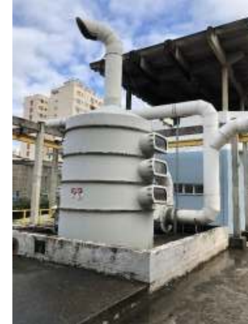
Figura 173: Lavador de Gases.
