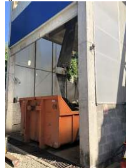
Figura 219: Lodo Desidratado Armazenado.
