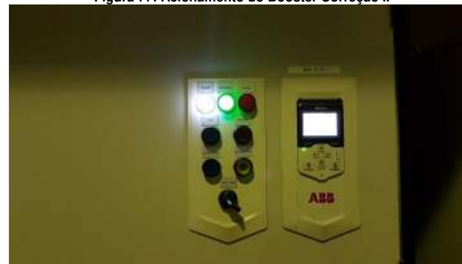
Figura 77: Acionamento do Booster Correção I.
