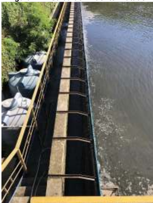
Figura 217: Saída do Efluente Tratado.
