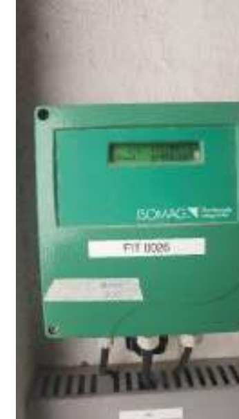
Figura 118: Macromedidor do Reservatório Caramujo.
