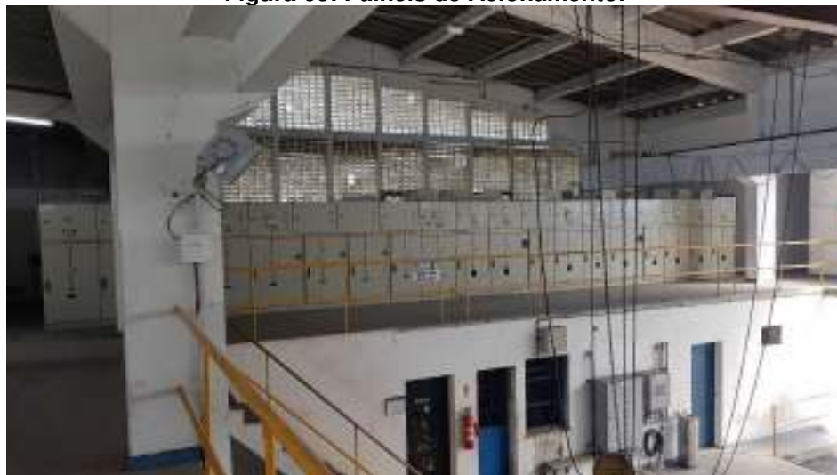
Figura 63: Painéis de Acionamento.
