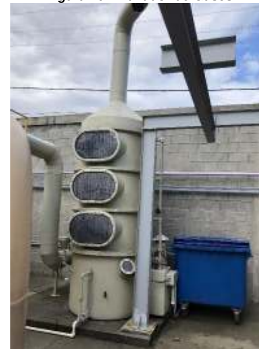
Figura 162: Lavador de Gases.
