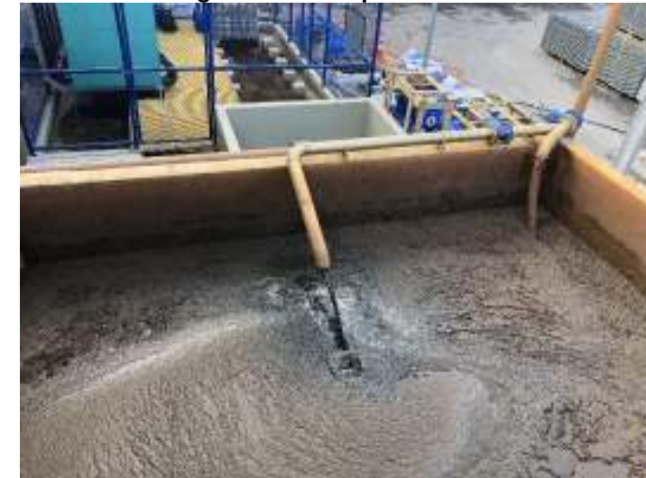
Figura 159: Tanque de Lodo.
