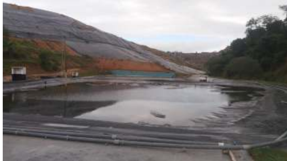
Figura 319: Lagoas de armazenamento temporário do chorume.
