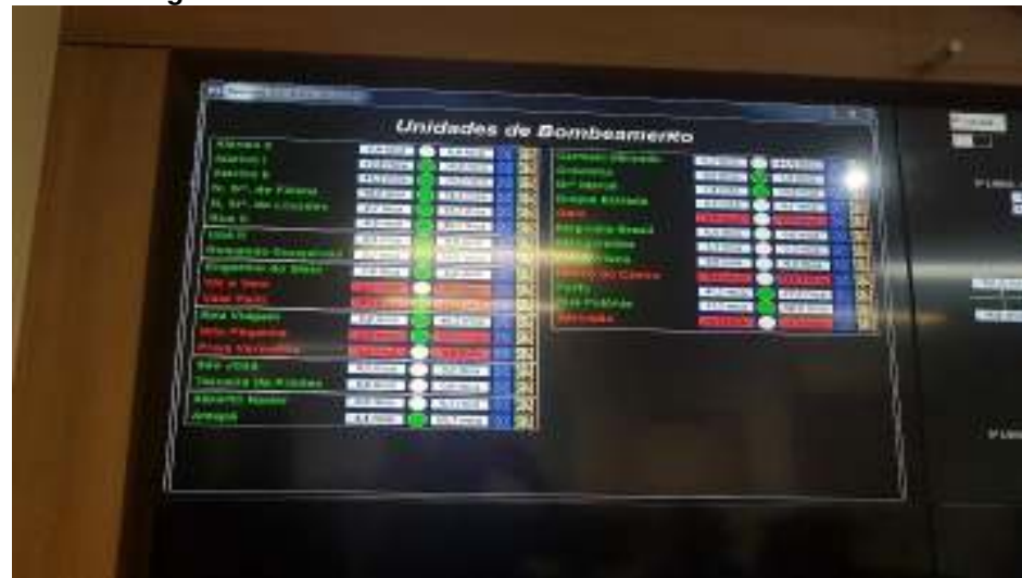
Figura 371: Elevatórias de Menor Porte com Telemetria.
