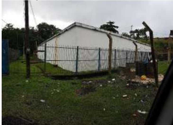
Figura 97: Reservatório Santa Bárbara.
