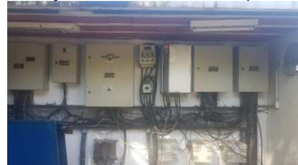
Figura 74: Acionamento do Booster Ilha de Conceição.
