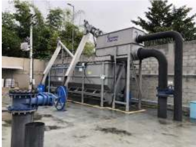
Figura 196: Tratamento Preliminar Automatizado.
