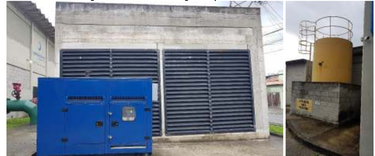
Figura 89: Gerador de Energia e Depósito de Óleo Diesel.
