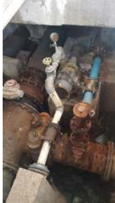
Figura 81: Booster do Reservatório Cavalão.
