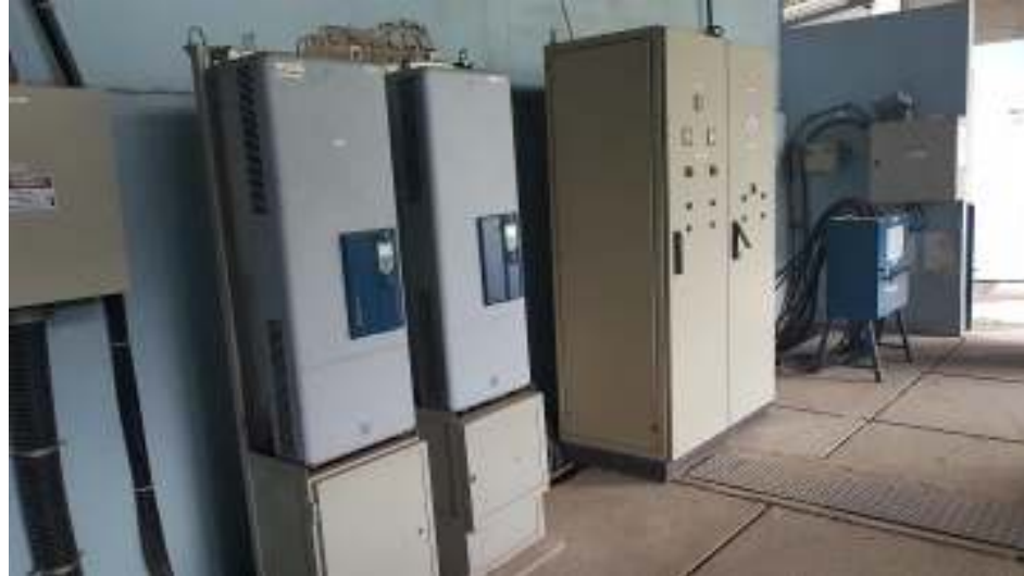
Figura 93: Acionamento do Booster Santa Bárbara-Caramujo.
