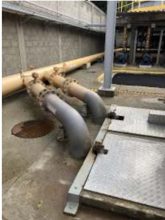
Figura 157: Entrada do Esgoto na ETE Camboinhas.
