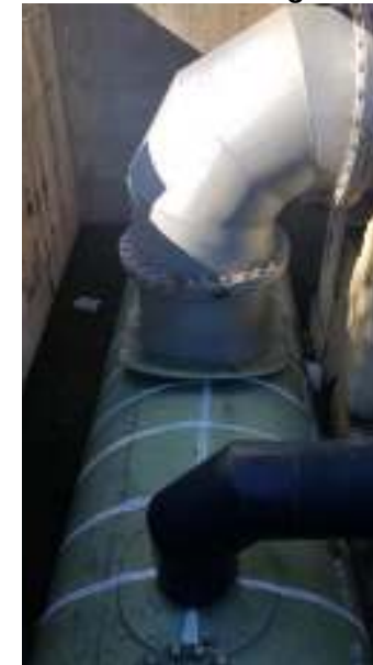
Figura 64: Adutora de Água Tratada.
