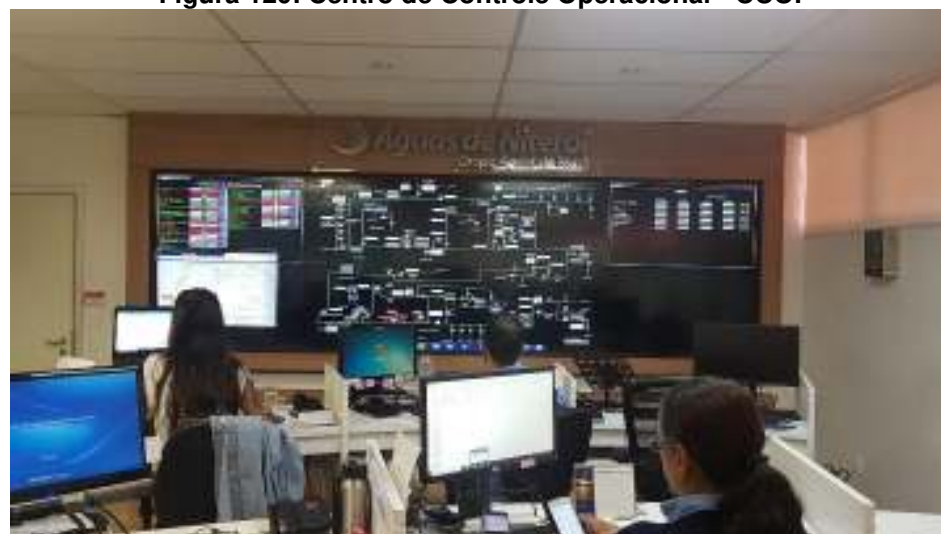
Figura 120: Centro de Controle Operacional - CCO.
