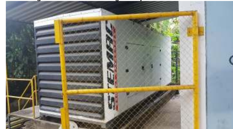
Figura 96: Gerador de Energia e Depósito de Óleo Diesel.
