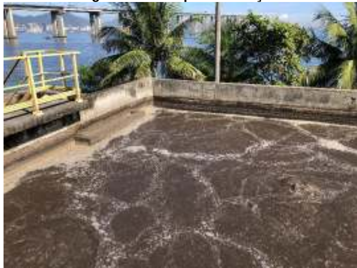
Figura 204: Tanque de Aeração.
