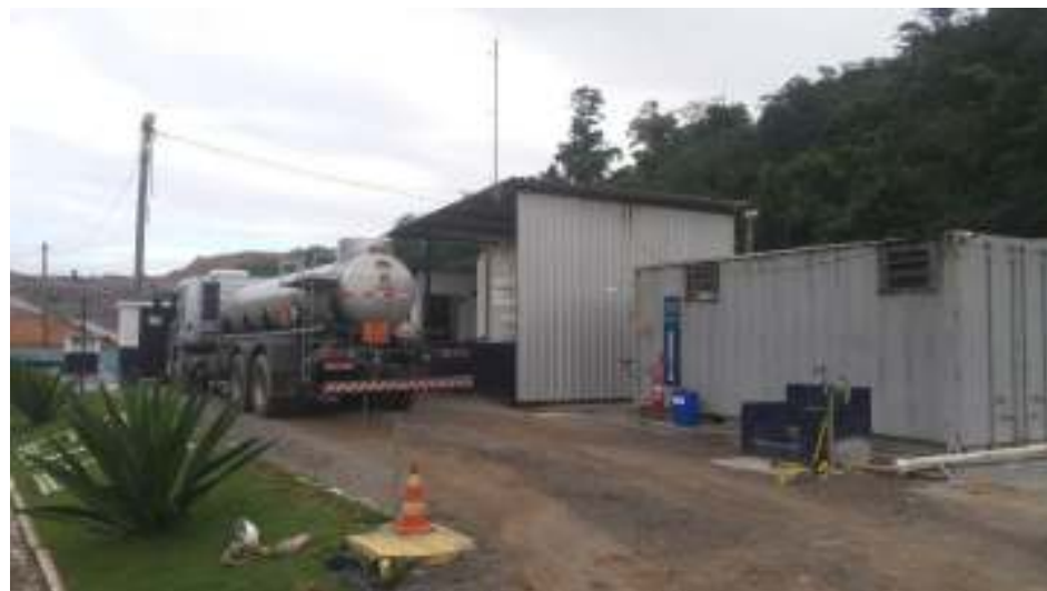
Figura 320: Vista geral da Estação de Tratamento – Osmose Reversa.
